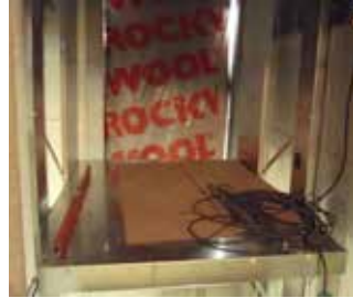
Risque de chute de l'intérieur de la cabine
