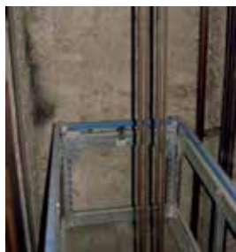
Αμίαντος στους τοίχους του φρεατίου - κίνδυνος σοβαρών επιπτώσεων στην υγεία εάν έρθει σε επαφή ή αφαιρεθεί χωρίς προφυλάξεις.
