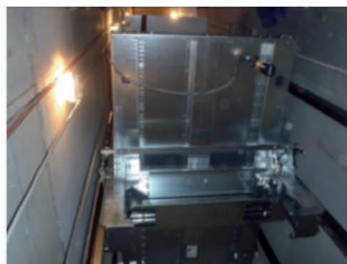
Kabina przymocowana do lin i zamontowany ogranicznik
